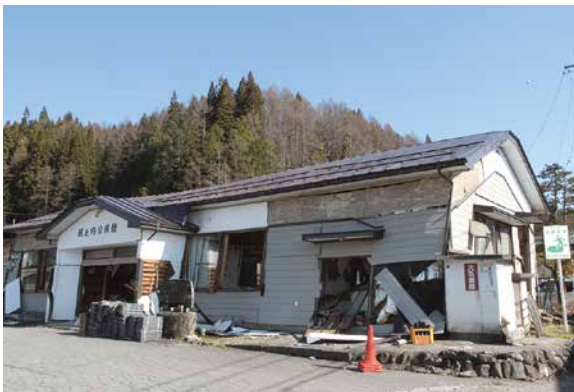
一次避難所に指定されていた堀之内公民館も被災（堀之内区）
