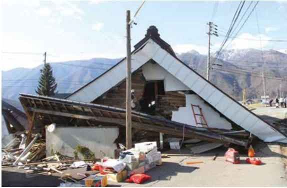
倒壊し道路をふさいだ家屋（堀之内区）
